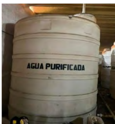
Figura 2.2. Tanques de agua tratada
