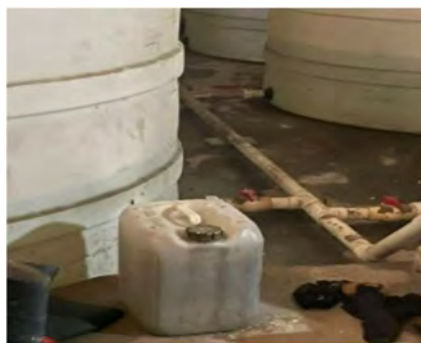
Figura 2.6. Válvulas de paso
