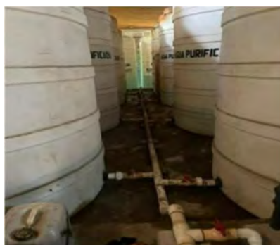
Figura 2.3. Sistema de tuberías de PVC de 2" y 1/2"
